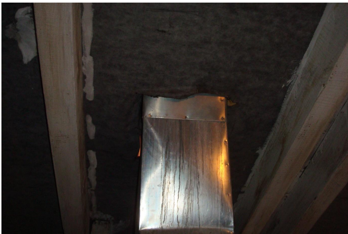
F14 Dané oplechování pouze v proříznuté fólii, viditelné stékání vody
