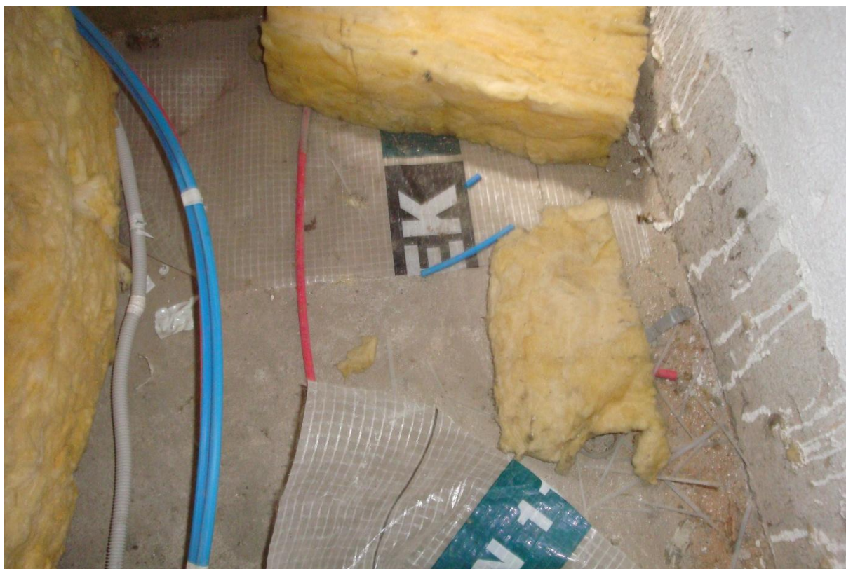
F20 Netěsná parozábrana a úprava u zdiva – bez komentáře
