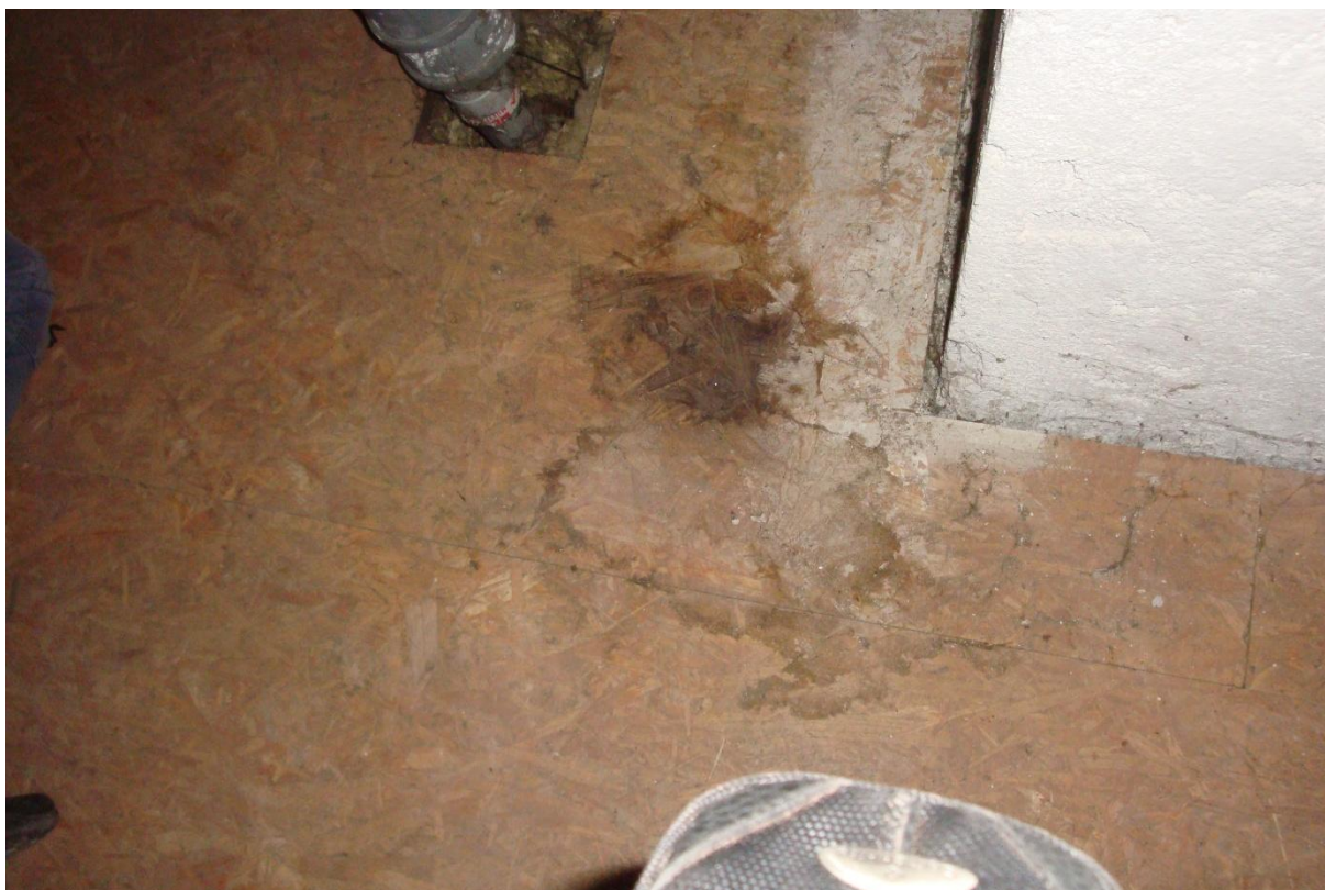
F17 Silné zatékání na OSB desku, proříznutí v podlaze bez dotěsnění
