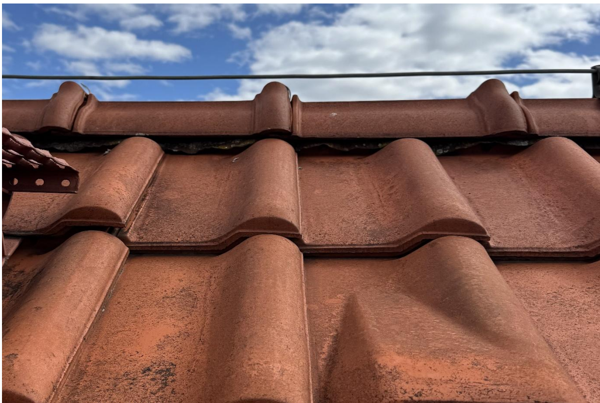
F40 Pod hřebenem krátký větrací pás již nedržící tvar vlny - zatéká
