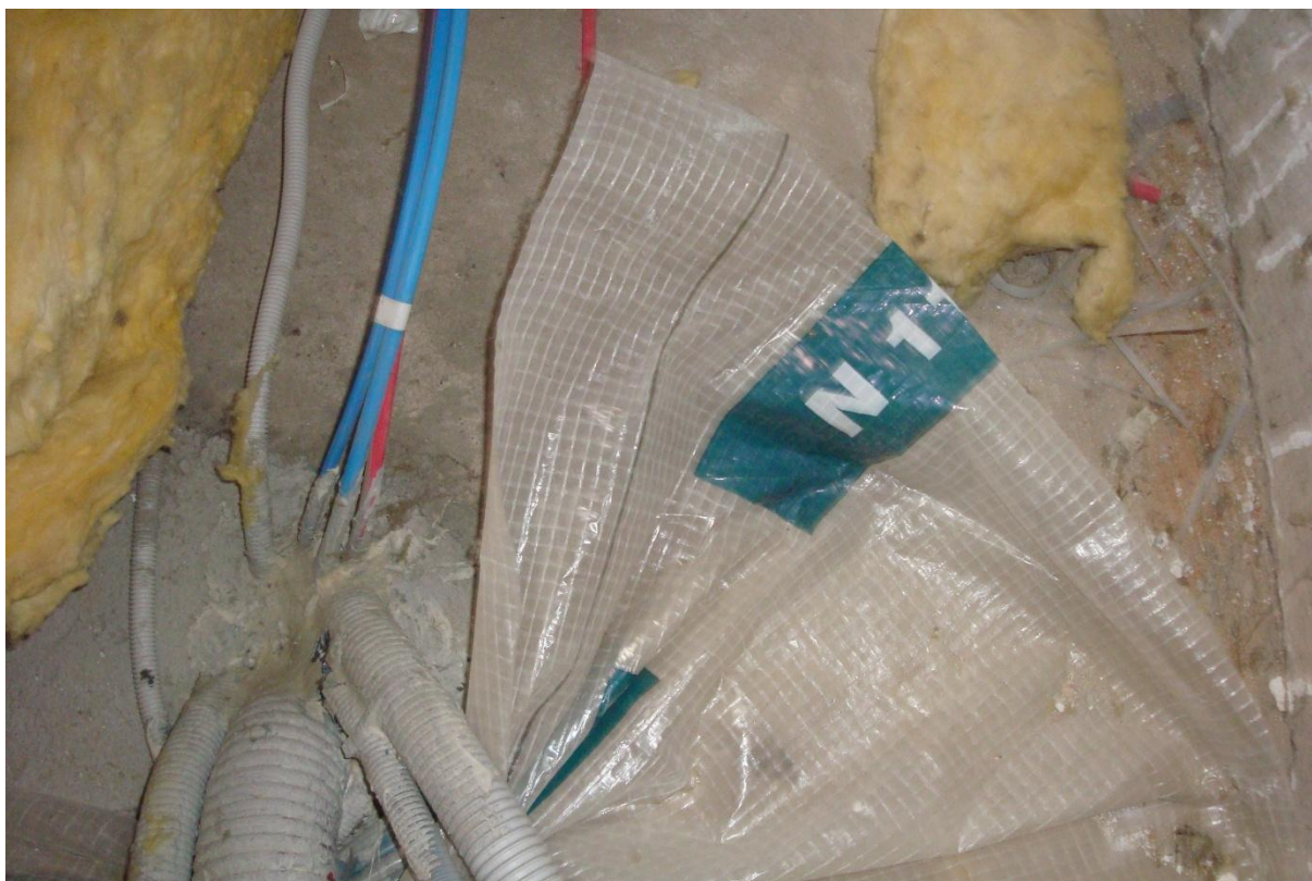
F19 Prostupy kabelů a parozábrana v podlaze – bez komentáře
