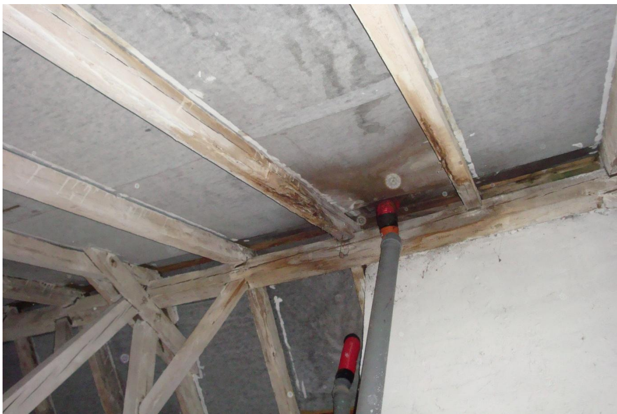
F23 Silné zátoky okolo odvětrání kanalizace a napadení krovu
