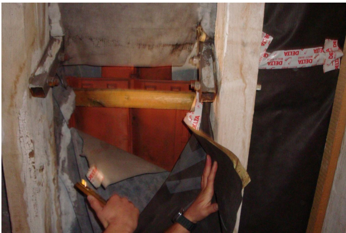
F24 Silné zatékání okolo upevnění pochozí lávky do krovu
