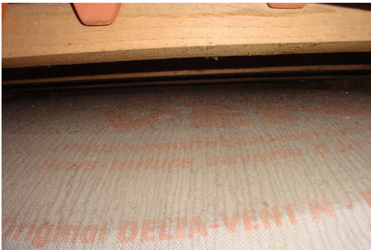
F36 Silně protékající nefunkční fólie v ploše
