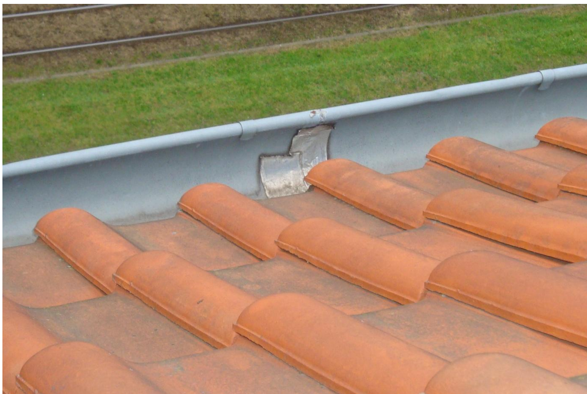
F31 Ukázka opravy prasklého žlabu butyl páskou – bez komentáře
