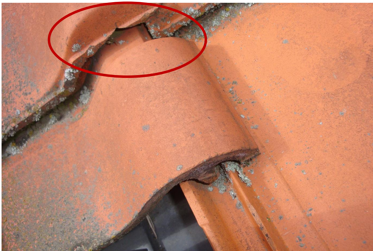
F26 Trhliny v patě tašky
