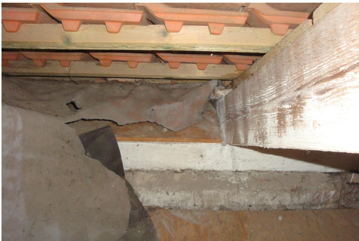
F12 V jiné části potrhaná rozpadlá fólie, kontralať uzavřená v bedněň
