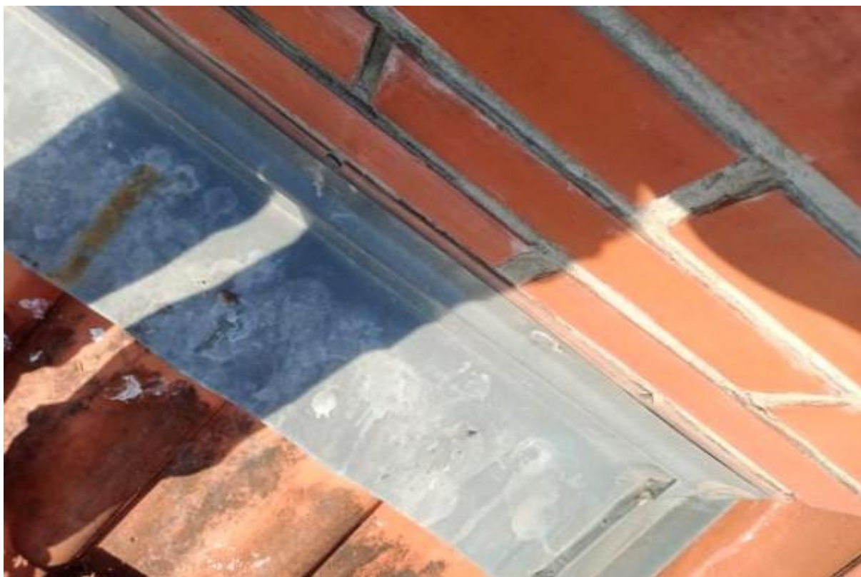
F32 Již zdestruovaný plech lemování komínu, chybně oizolované ke zdivu
