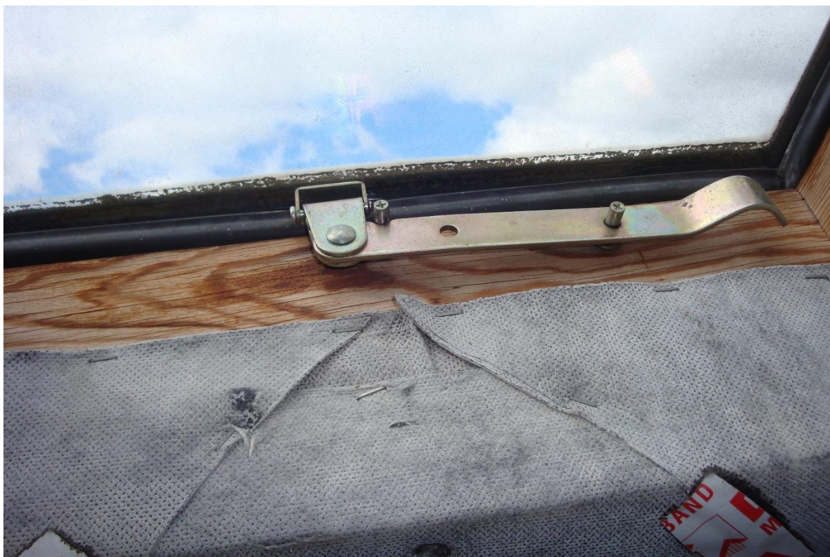
F3 Úprava difúzní fólie okolo výlezového okna, stéká voda
