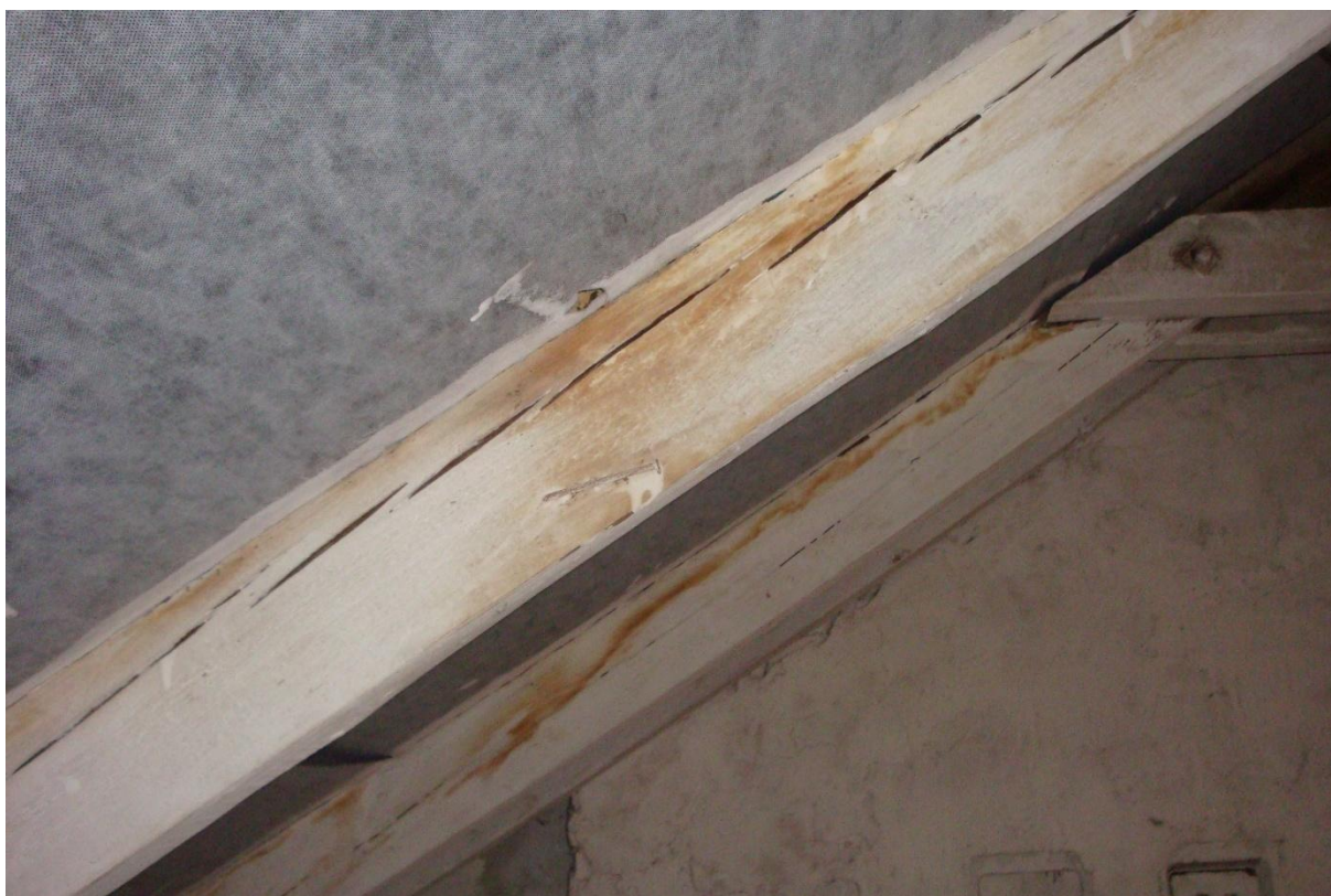
F22 Zátoky na krovu v jiném místě
