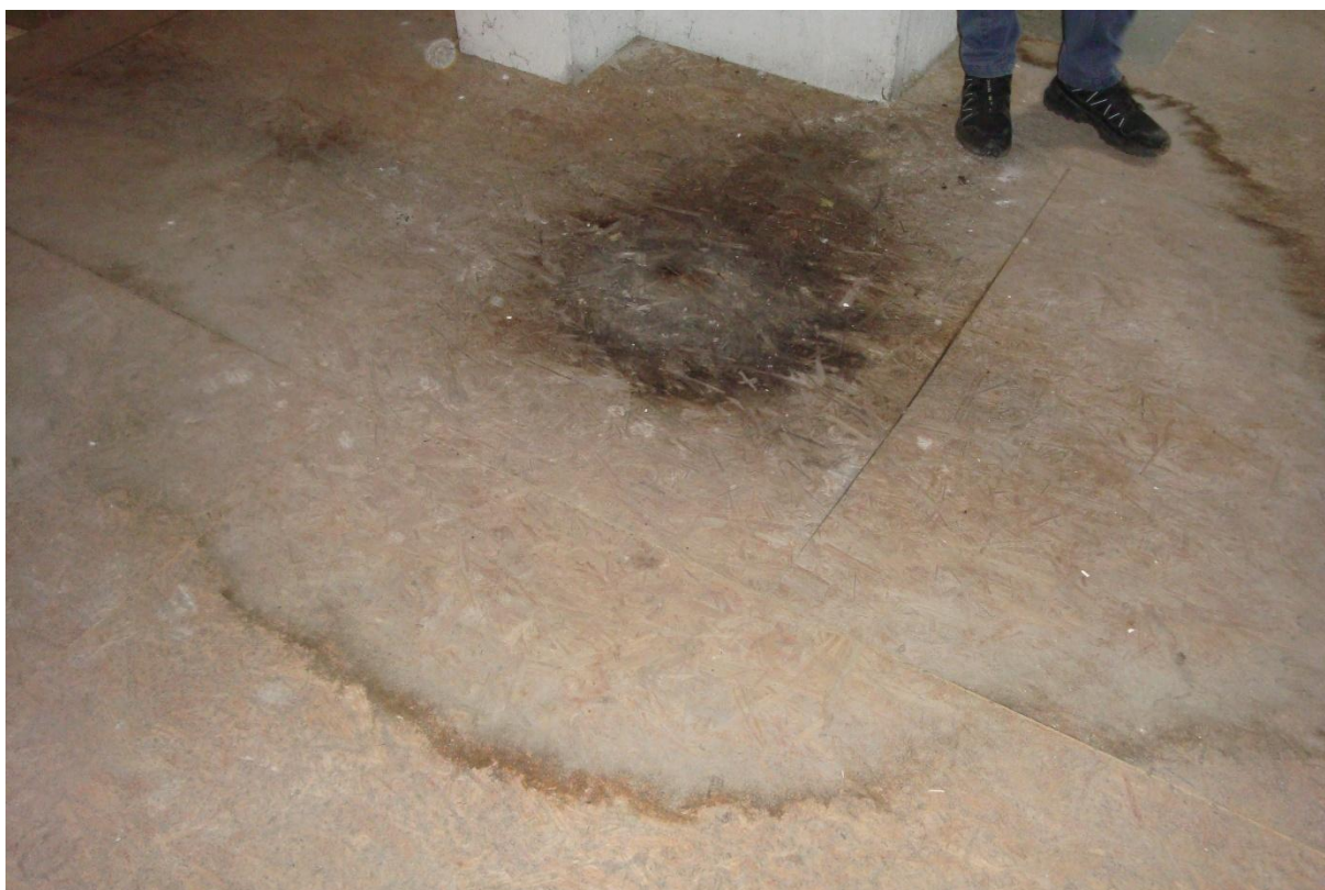
F18 Silné zatékání viditelné na OSB desce v jiném místě
