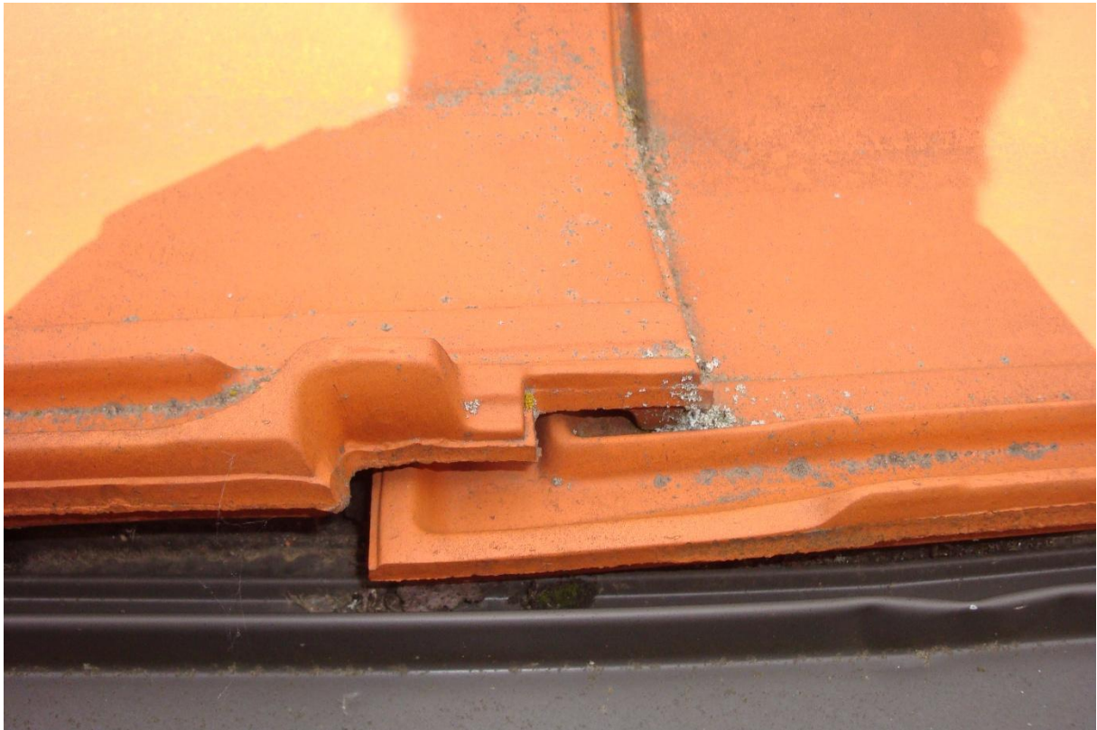
F29 Chybně osazené tašky v zámčích, moc sražené
